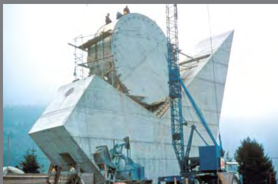
Construction du monument national à la Résistance, Émile Gilioli, 1973, Plateau des Glières
