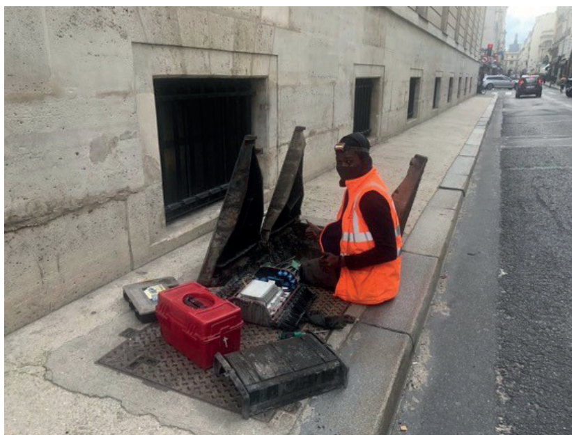
Figure 7 : Un opérateur de la couche physique de la rue (intervention sur les câbles téléphoniques) Rue Richelieu à Paris, septembre 2020 – Photo ibicity
