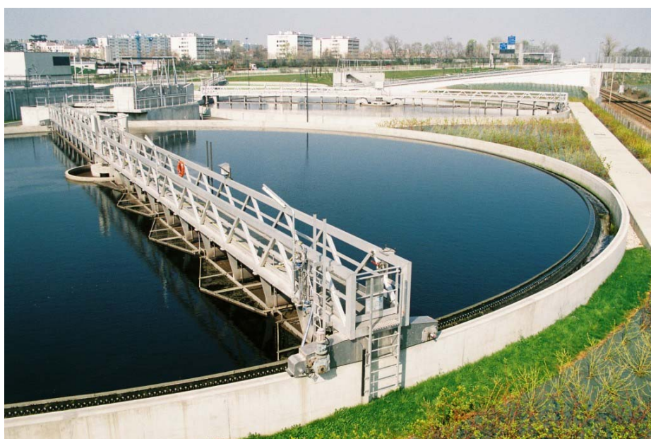
Usine d'assainissement de Pierre bénite © Cédric Darbord
