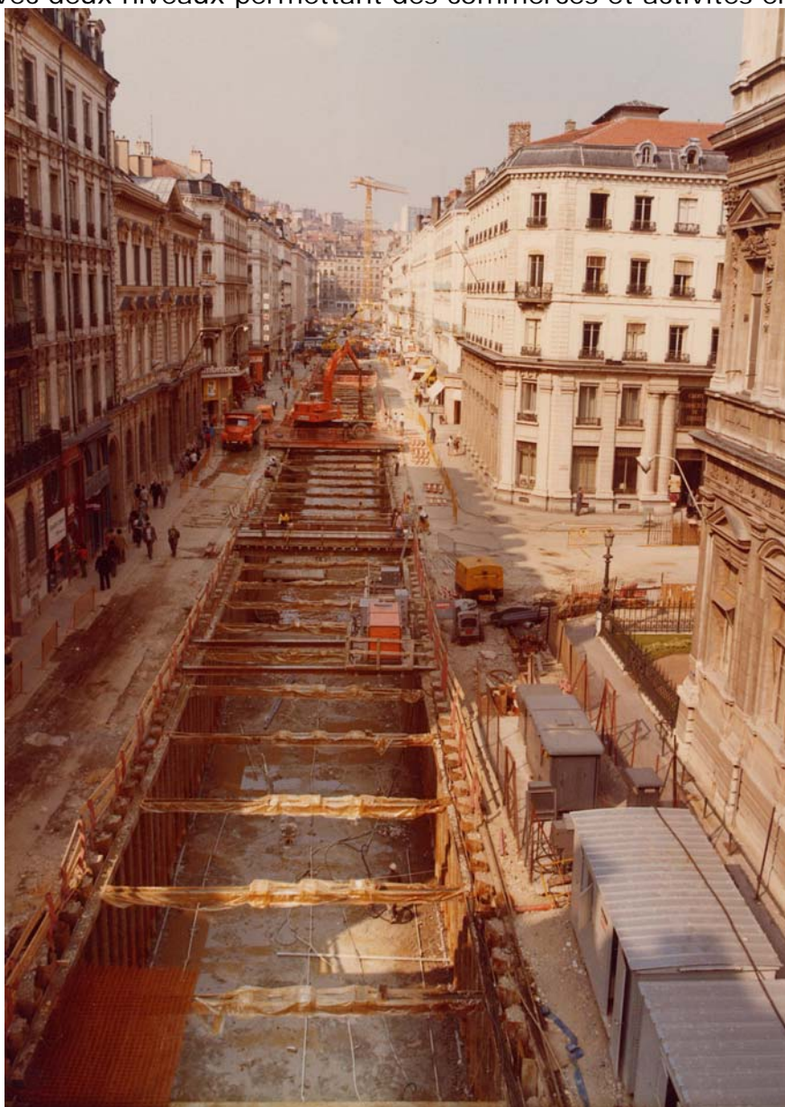
Rue de la République. Construction du cadre, terrassement de la nappe phréatique – septembre 1975 - SEMALY - STUDIO VILLEURBAINAIS
