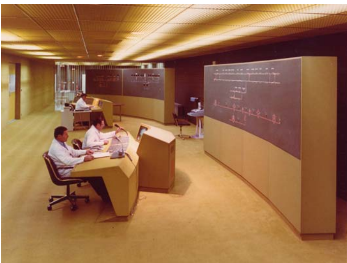
Vue générale du poste de commande centralisées (PCC) à la Part-Dieu – octobre 1979 – SEMALY-BASSET
