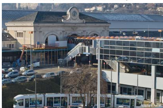
Arrivée du tramway sous le centre d'échanges de Perrache et traversant la gare SNCF
