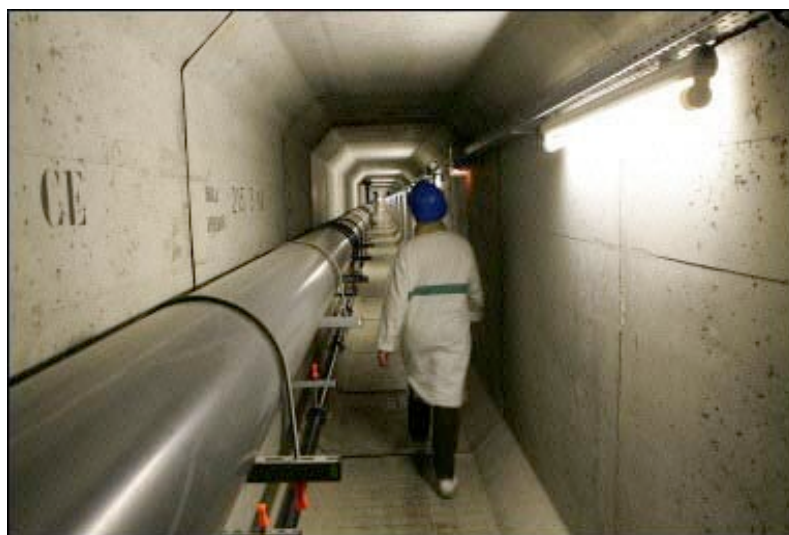
Vue de canalisations souterraines protégées (DR)
